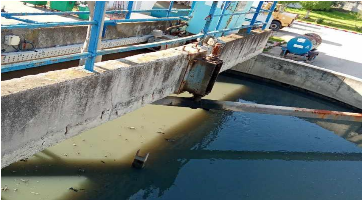
Figure IV.5 : Dessableur-dégrilleur de la STEP de Boumerdes
