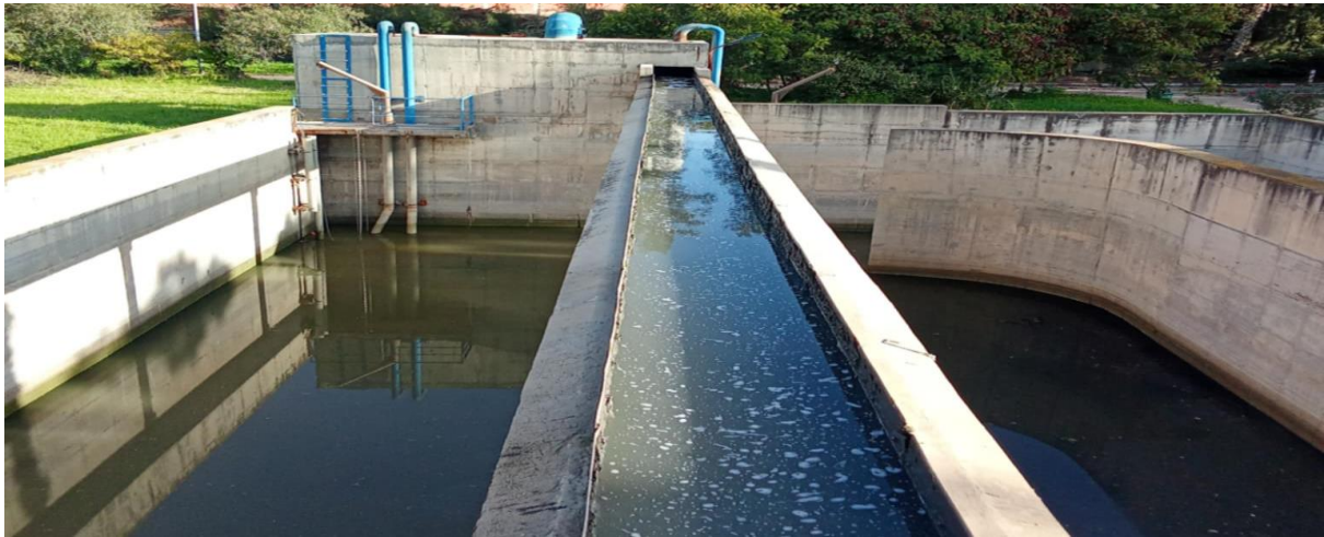
Figure IV.3 : Bassin d'orage de la STEP de BOUMERDES
