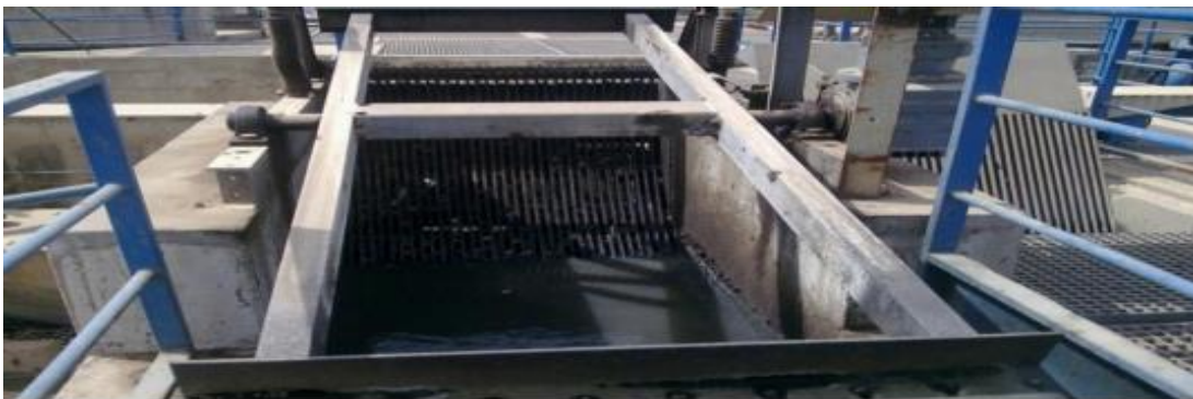
Figure IV.4 : dégrilleur de la STEP de Boumerdes
