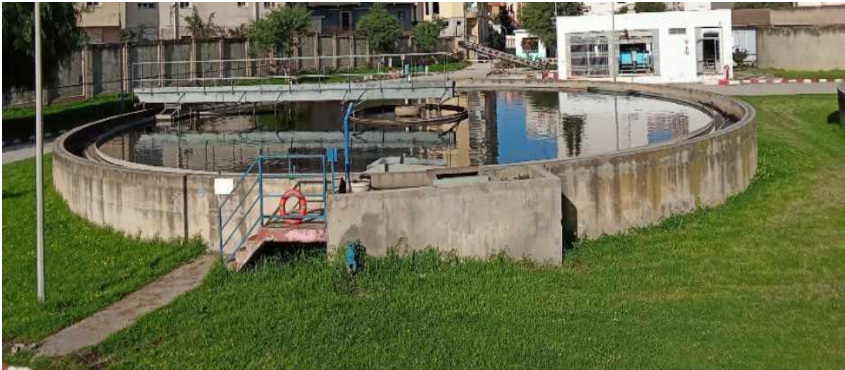
Figure IV.7: Clarificateurs de la STEP de Boumerdes
