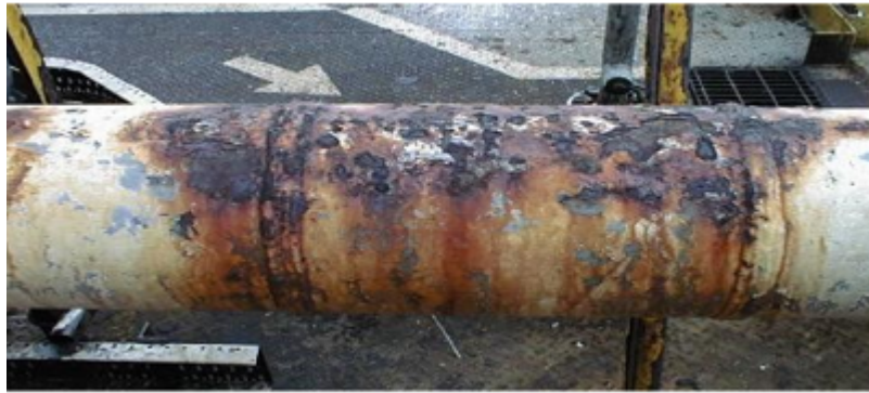
Figure III.9 : Exemple d'une corrosion externe
