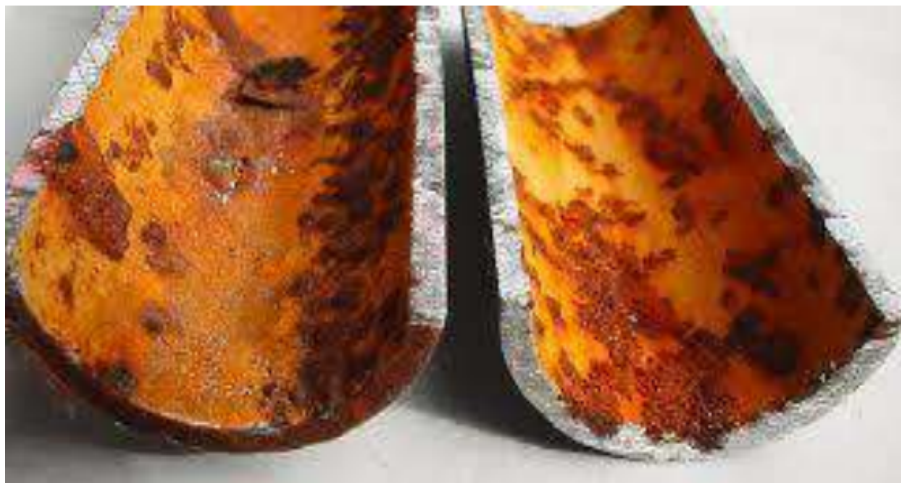
Figure III.8 : Exemple d'une corrosion interne
