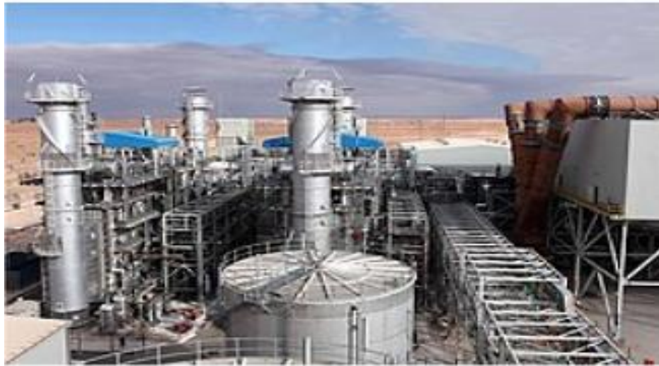
Figure I.5 : La centrale électrique hybride de Hessi R'mel à Laghouat.
