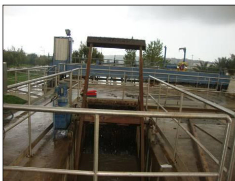
Figure N°10 : Le dégrilleur automatique.
