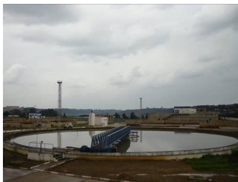
Figure N°12 : Le décanteur primaire.
