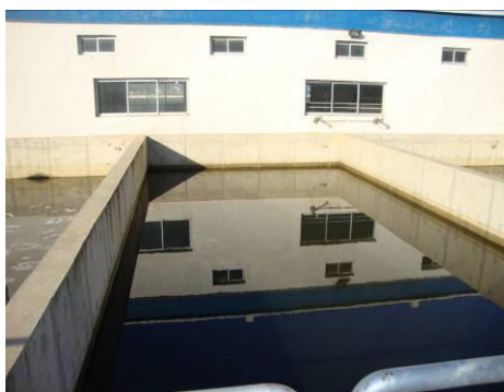
Figure N°15 : Le filtre à sable.
