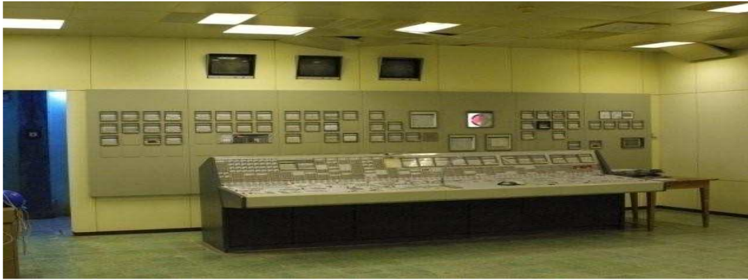
Fig.I.1 : Salle de commande.
