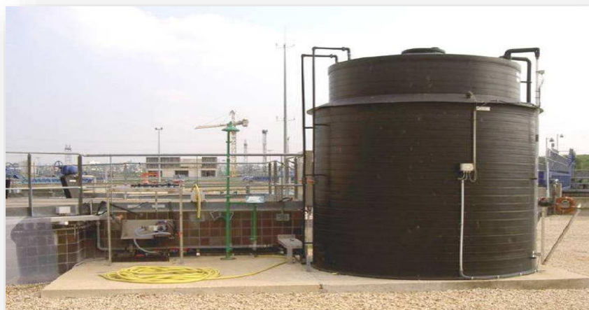
Figure V.41 : STEP de Valenton (poste fixe pour chloration)
