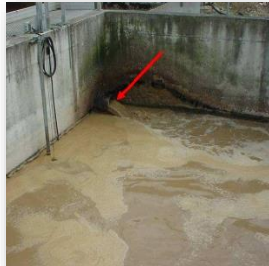
Figure V.40 : Recirculation boues dans zone de contact
