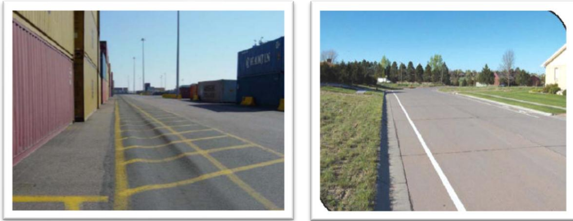
Figure I.9. Orniérage des revêtements en béton bitumineux et état d'une chaussée en BCR après 11 ans de service.
