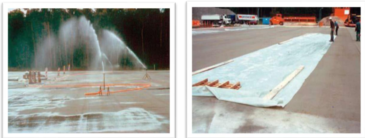
Figure.I.5 : Cure du béton par arrosages ciblés et bâche de protection contre la pluie [26].
