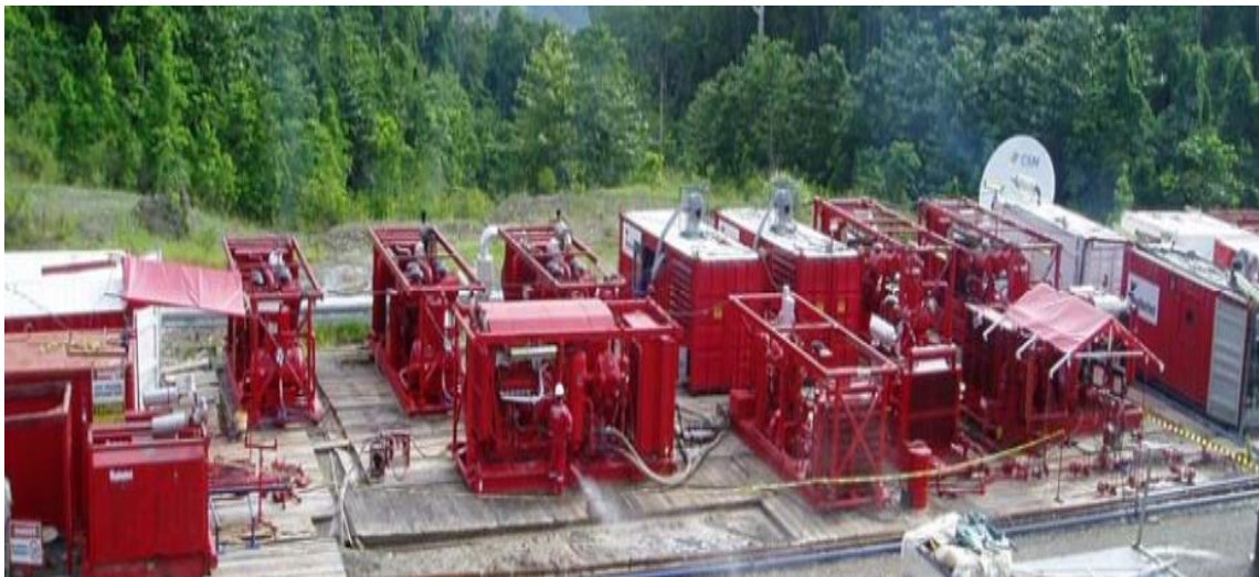
Figure III.4: Système de production d'azote pour 3000 scft/min installé sur place
