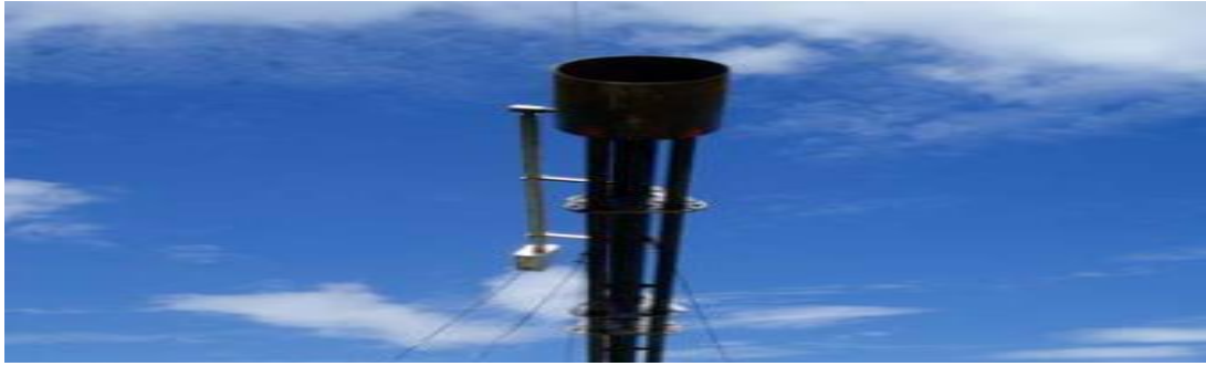
Figure III.24 : Sommet d'une torche
