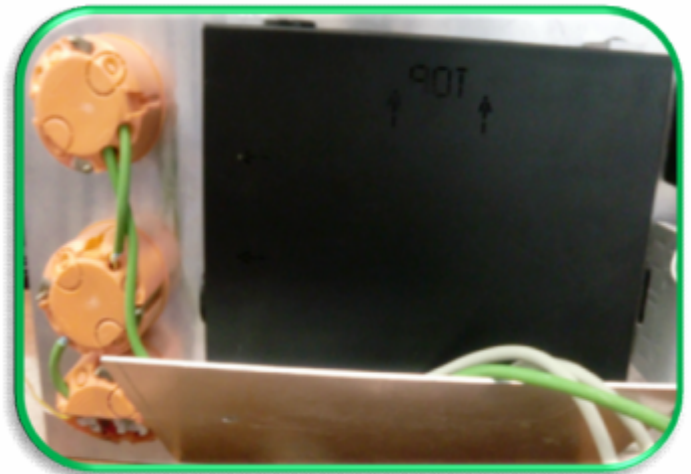
Image derrière de panneau de commande
