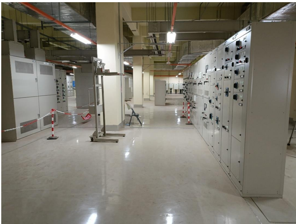
Figure III.1 : Salle de commutation électrique phase III
