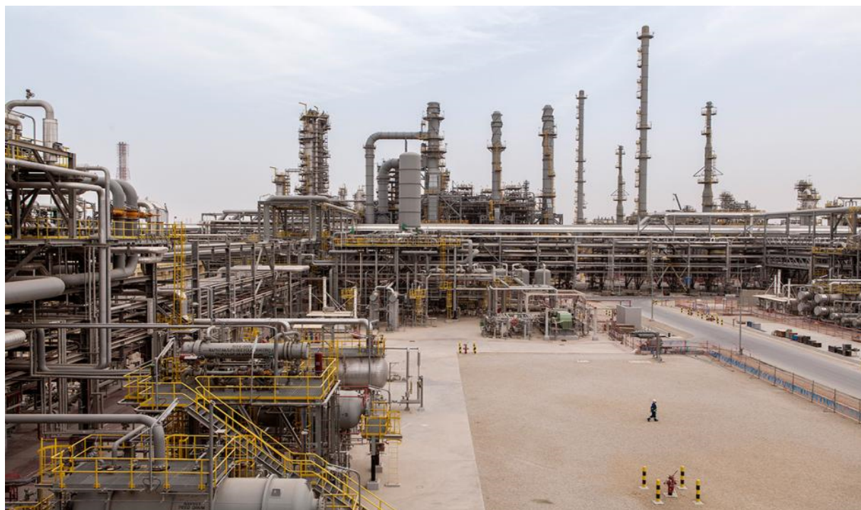
Figure I-3 : Unité de production d'hydrogène par vaporeformage à la raffinerie d'Al-Jubail, en Arabie saoudite [7].
