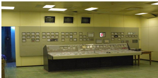
Figures I.7 : Salle de commande
