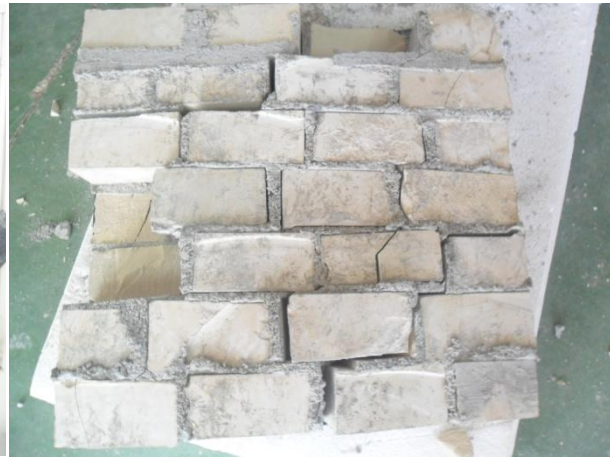
Figure IV.19 : décollement de quelques pierres
