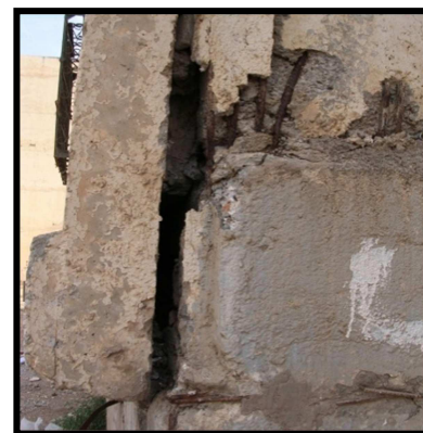
Fig.II.10: armatures de scellement corrodées suite à l'éclatement de la couche d'enrobage, dommages non sismique.
