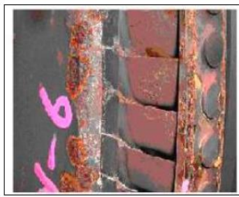
Rotor : Corrosion et érosion aubages mobiles entre le quatrième et le dixième étage
