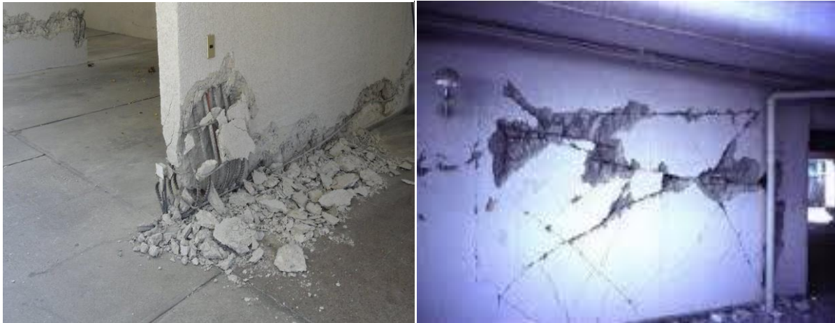
Fig. II.9. Dégâts subis par les voiles.
