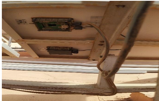
Figure III .3. Défaut de déconnection de la diode (URAER)
