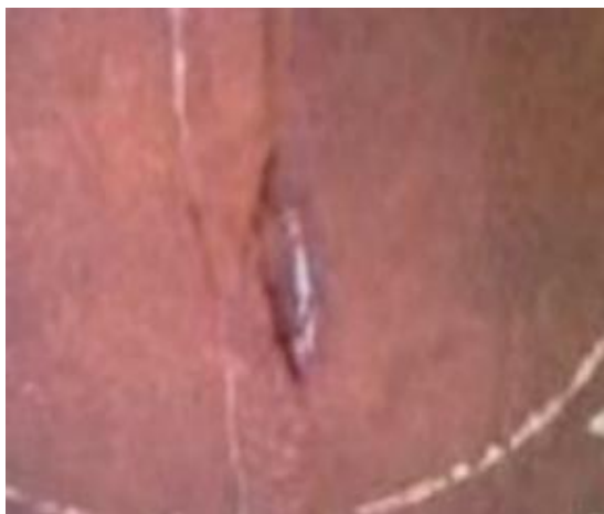
Figure II.2: Corrosion généralisée et localisée [3]
