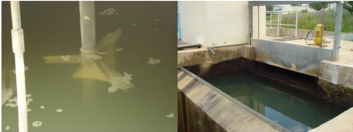
Photo 1.3 : Bassin de Coagulation floculation.
