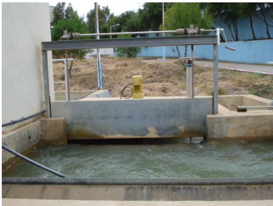
Photo 1.2: Prétraitement / Pré chloration (bassin de mélange).
