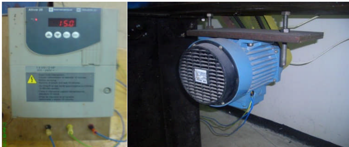
Figure III.12: Montage du Variateur de vitesse relié au moteur asynchrone
