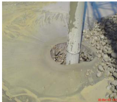
Figure.VI.5.Phénomène de liquéfaction local (site : barrage Kissir-Jijel).
