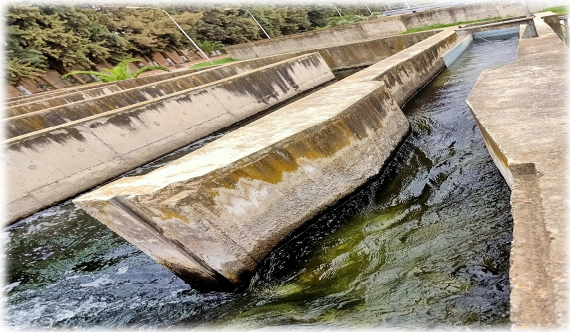
Figure III.8: ouvrage de désinfection
