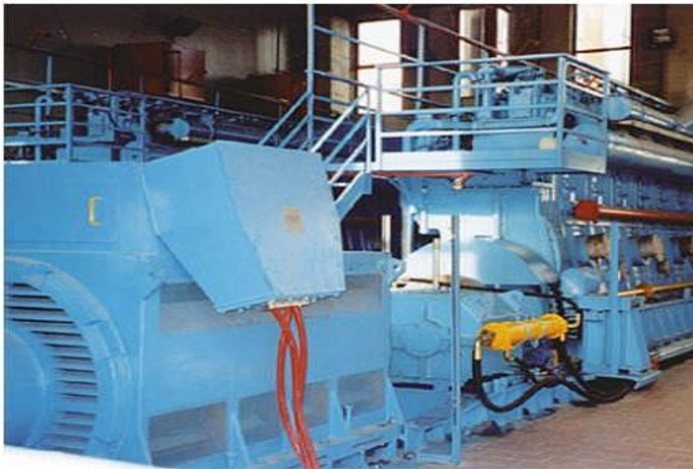
Figure I.3. Centrale électrique diesel fonctionnant au gas-oil, avec un moteur thermique à combustion et un alternateur
