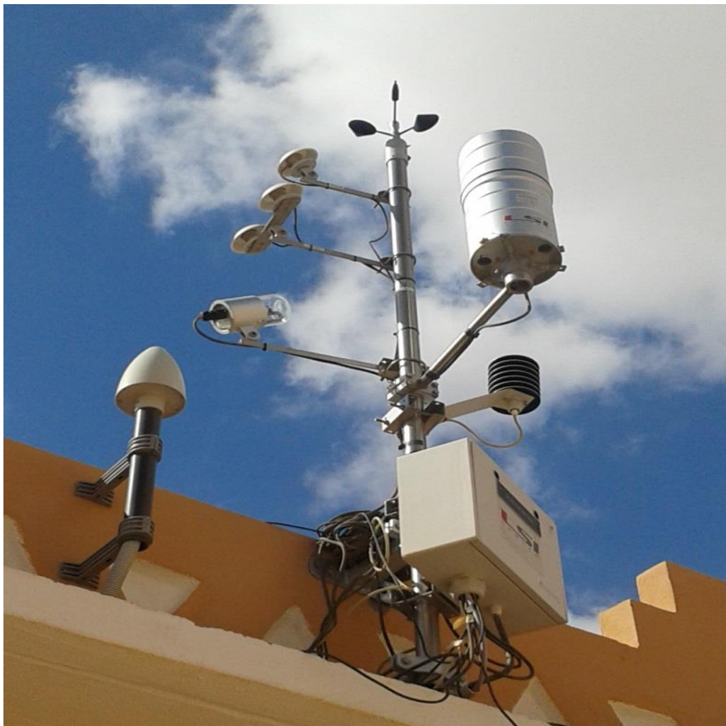
Figure III.3. Station météorologique de la centrale PV.
