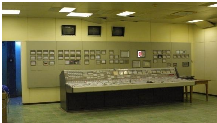
Figure 12 : salle de commande de la centrale
