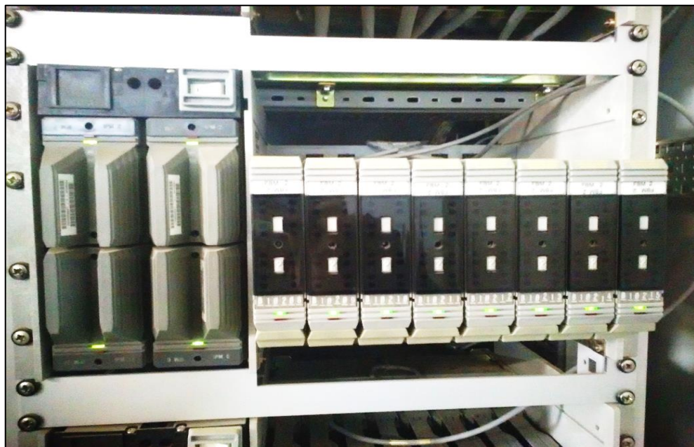
Figure III.3 : les modules E/S FBM
