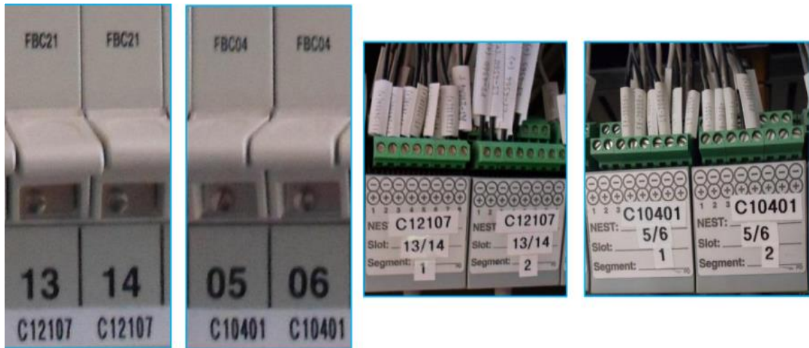
Figure V.3 : Adressage de FBC01 et FBC04 dans l'armoire des Racks.
