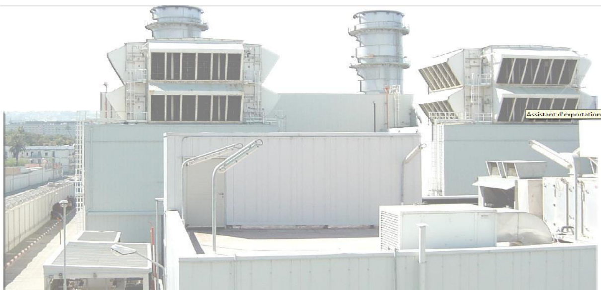
Figure I.5 : La centrale D'El Hamma II.
