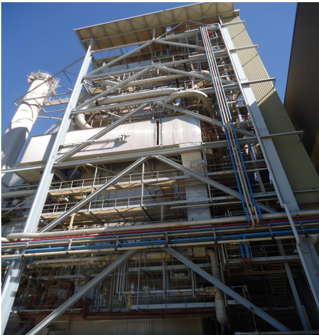
Figure I.1: Générateur de vapeur.
