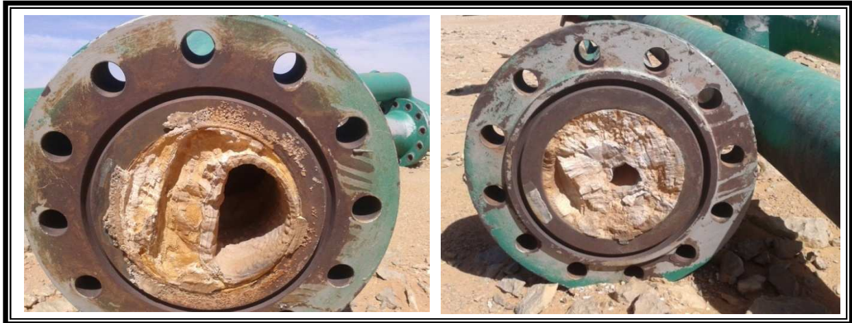
Figure 1.4: Dépôts BaSO 4 dans les conduites
