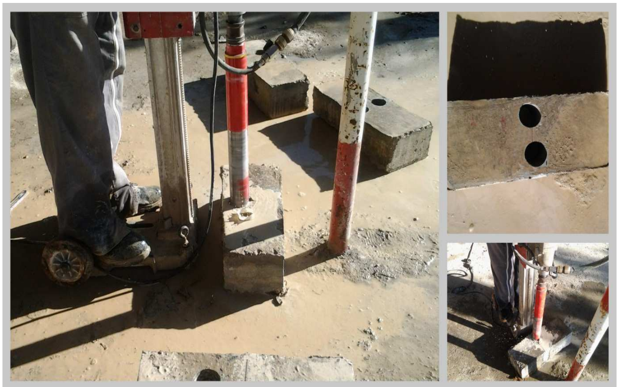
Figure-IV-6-Réalisation de carottage des différentes éprouvettes. (Fissurées et témoins).
