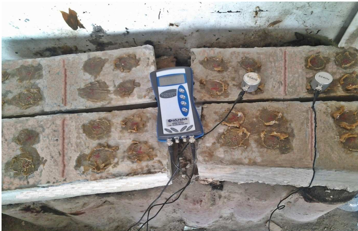
Figure-IV-5-Caractérisation ultrasonore de profondeur des fissures dans les éléments en béton.
