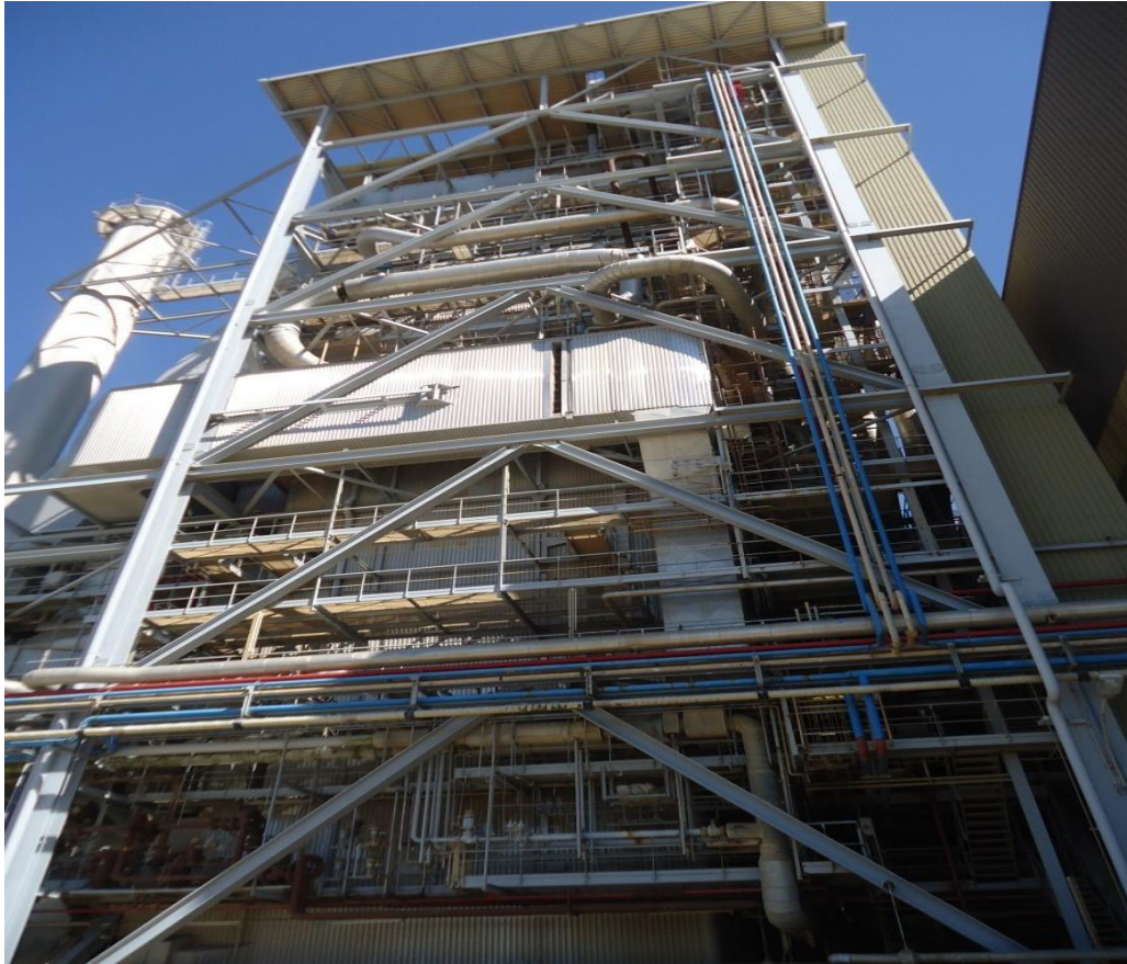
Figure I.7: Générateur de vapeur
