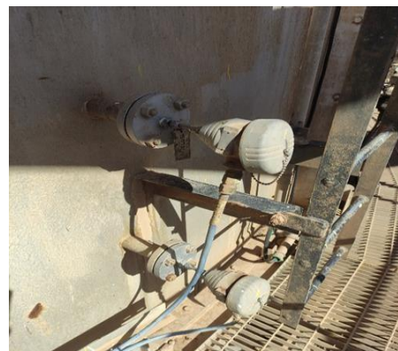
Figure 3.3. Le transmetteur de température sur site (TT+TE).
