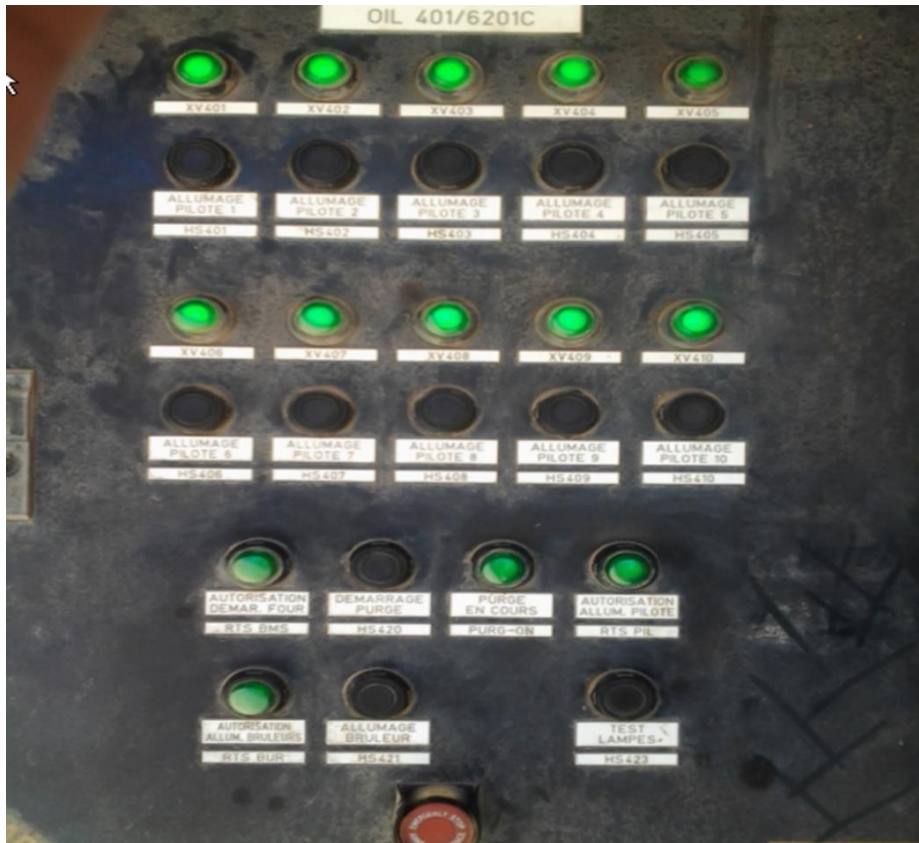
Figure 4.4 : Panneau local de four C sur site
