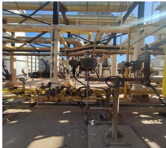
Figure 3.6. : PSSL sur site
