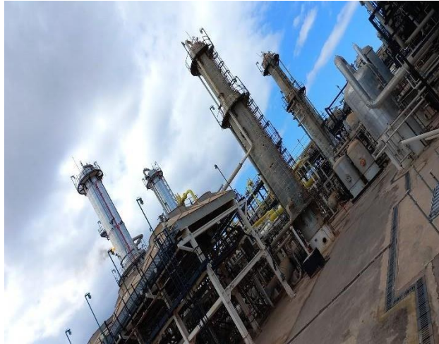
Figure 1.3 : Colonne de distillation sur site
