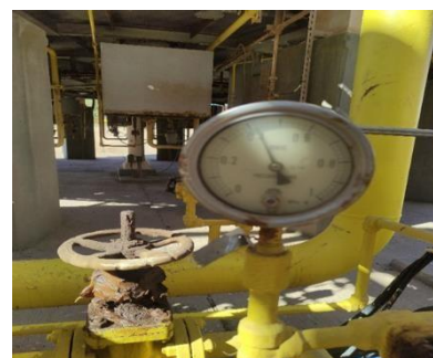
Figure 3.5 : Manomètre sur site
