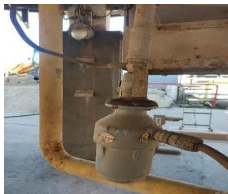
Figure 3.7 : Détecteur de flamme sur site (BE).
