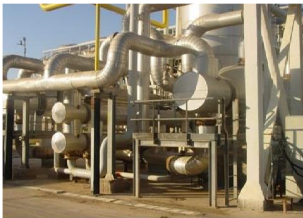
Figure 1.5 : Rebouilleur sur site
