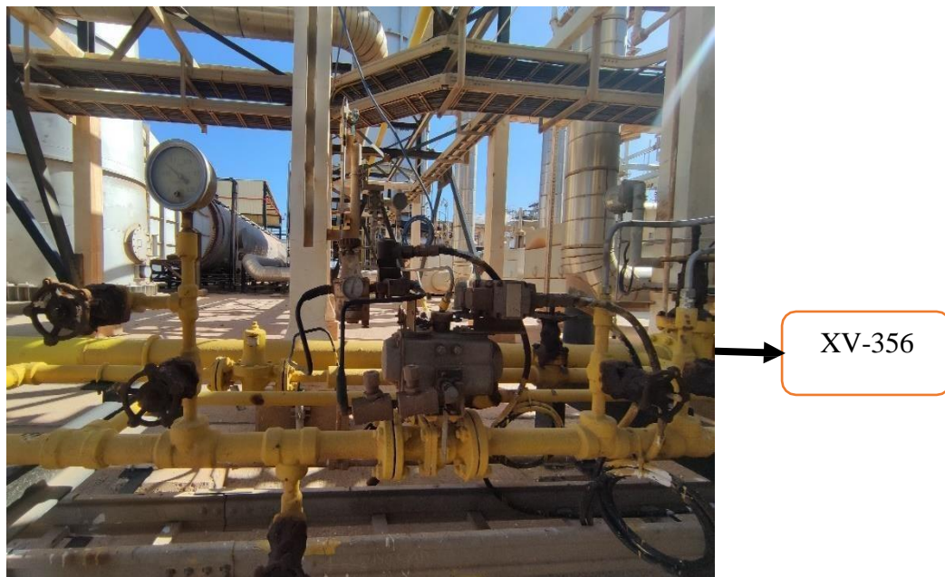
Figure 4.1 : Circuit pilotes sur site.
