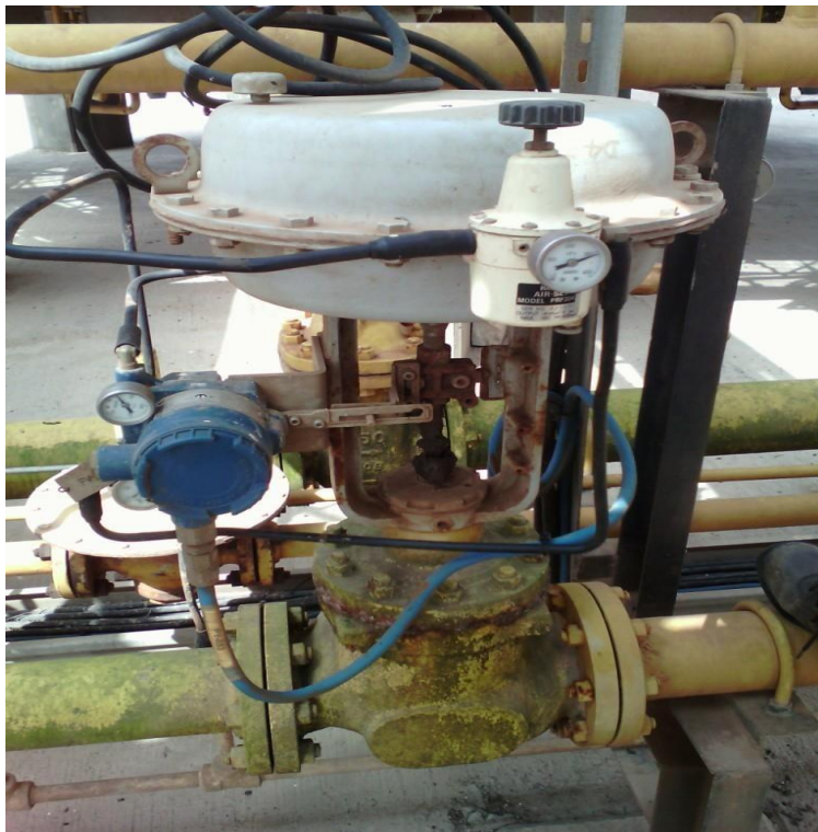
Figure 3.10 : Vanne régulatrice sur site
