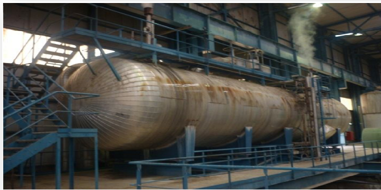
Figure .I.7. Vue d'une bêche alimentaire de la centrale [2]
