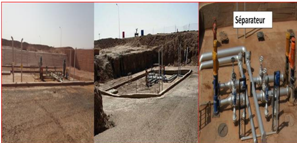
Figure09: Séparateur-décanteur n° 2 en activité( Bouguettaya, D., et al., 2023 )
