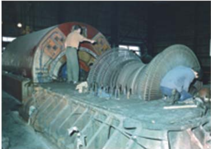
Photo 5 : connexion turbine BP et alternateur
