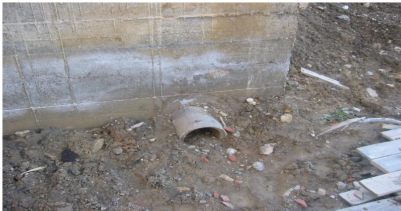
Figure IV-6: Occlusion du système de canalisation
