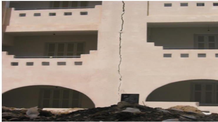
Figure IV-12: Ouverture des joints de dilatation des 30 logements
