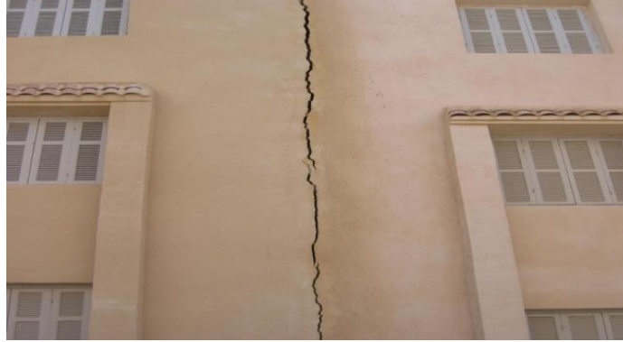
Figure IV-9: Ouverture des joints de dilatation des 40 logements
