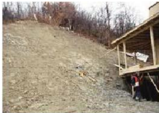
Figure I-19: Déblais ou excavation à la base du talus
