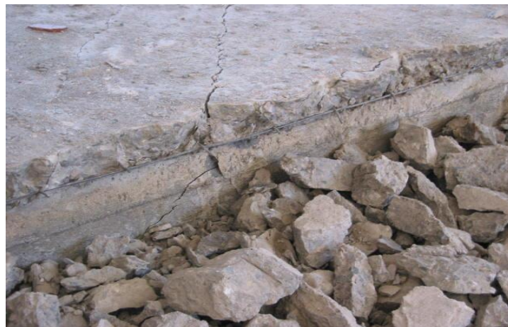
Figure IV-14: Fissurations au niveau des nervures des semelles filantes
