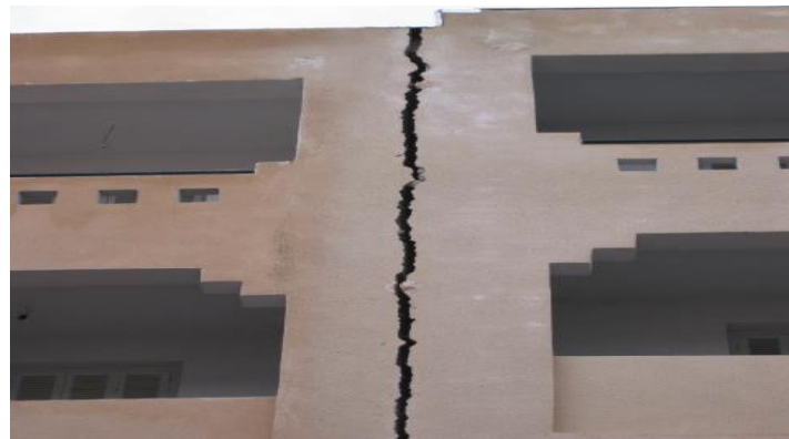
Figure IV-16: Ouverture des joints de dilatation des 40 logements
