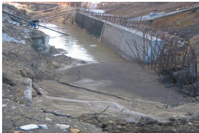
Figure IV-4: Présence d'eaux au niveau du mur de soutènement
