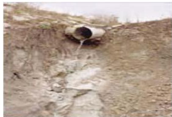
Concentration d'eau (érosion verticale).
