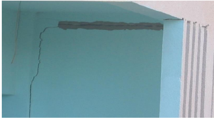
Figure IV-15: Fissures au niveau de la maçonnerie
