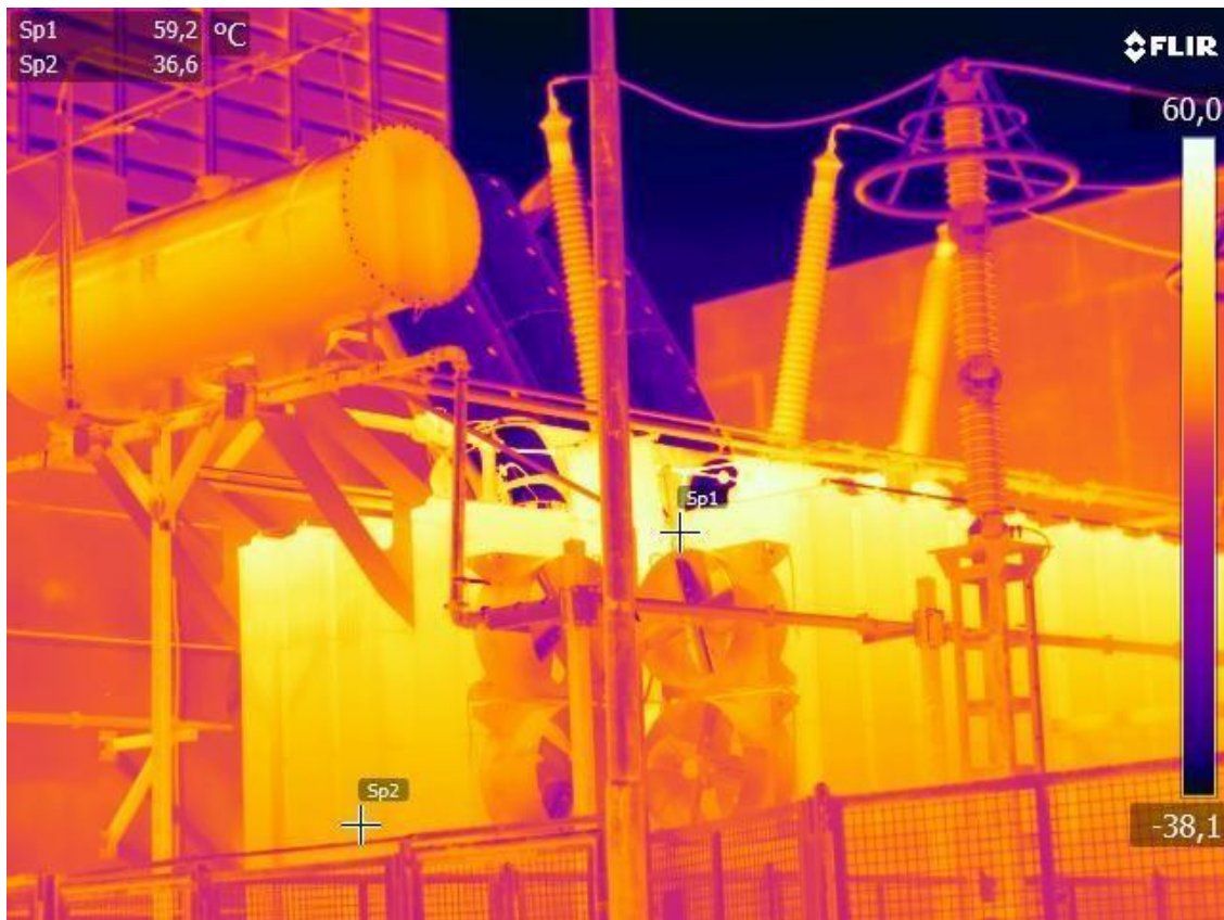
Figure IV.6 transformateur principal groupe N°2
