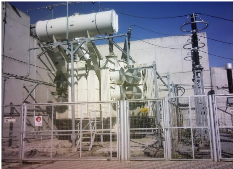
Figure IV.9 transformateur principal du groupe N°3.
