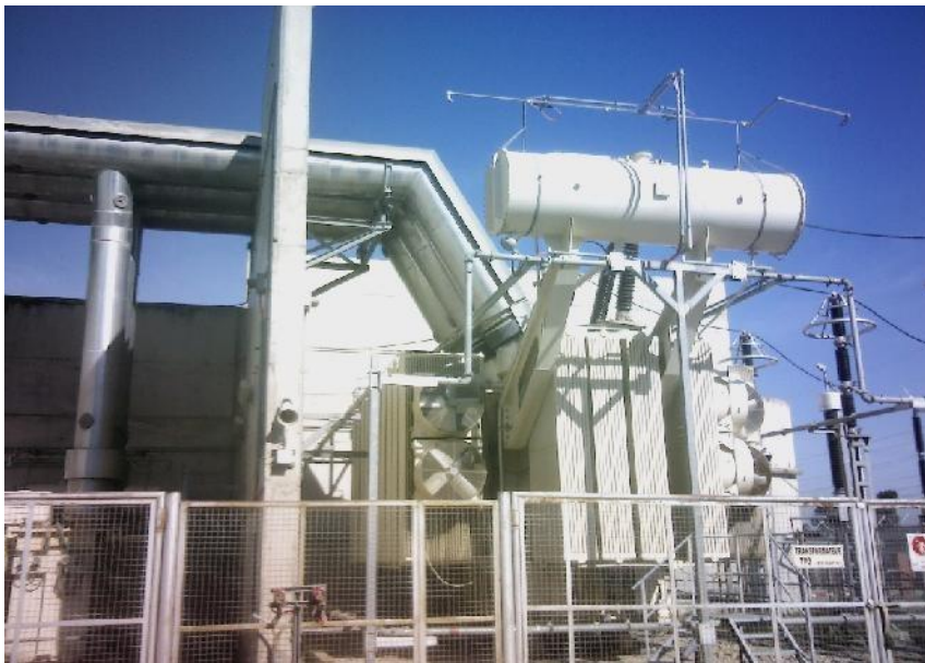
Figure IV.4 les gaines coaxiales MT du groupe N°2.
