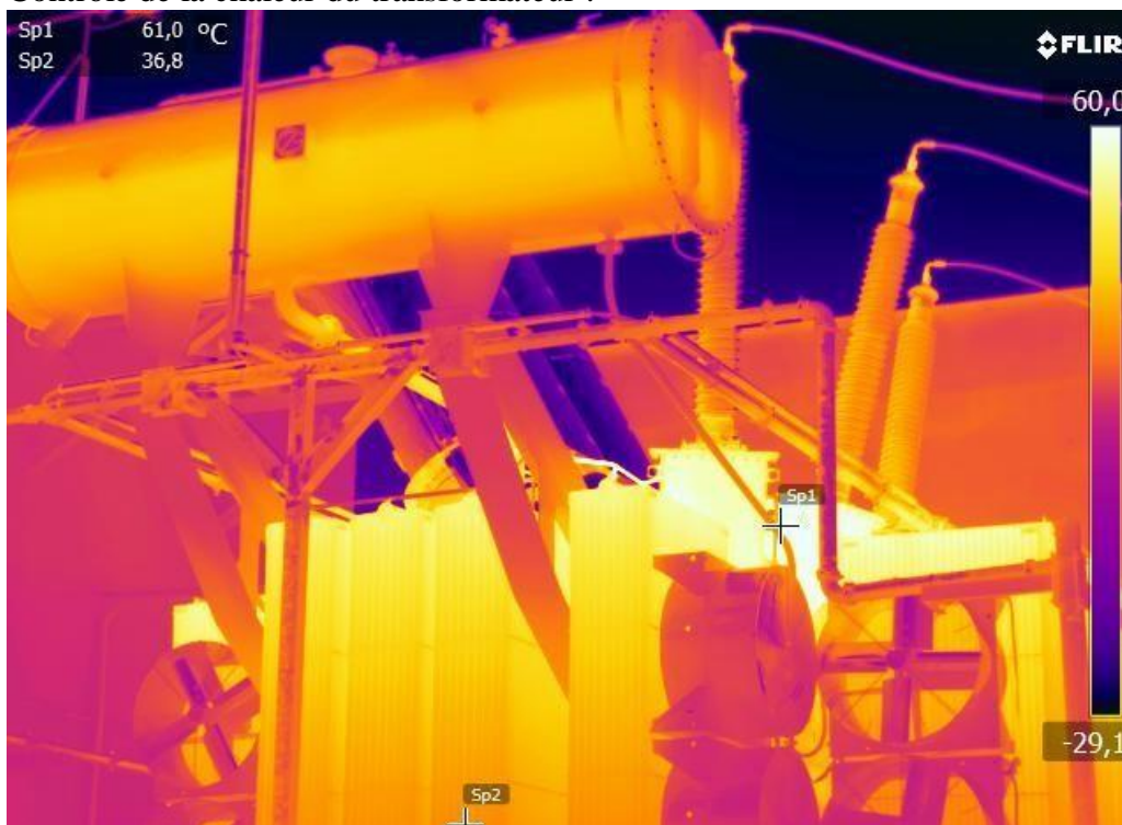
Figure IV.18 transformateur principal groupe N°4.
