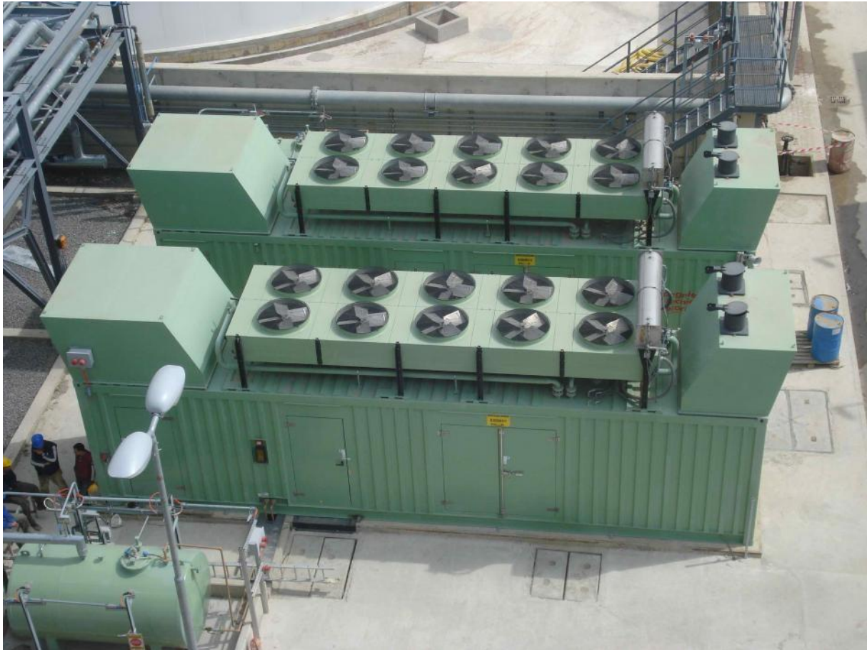
Figure I.11 deux groupes électrogènes de secours
