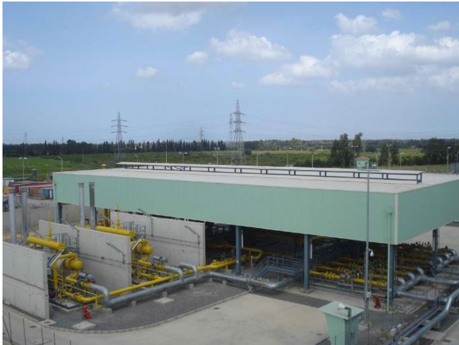
Figure I.5 station de détente du gaz.
