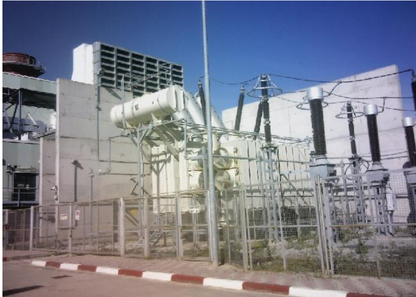
Figure IV.3 transformateur principal du groupe N°2.
