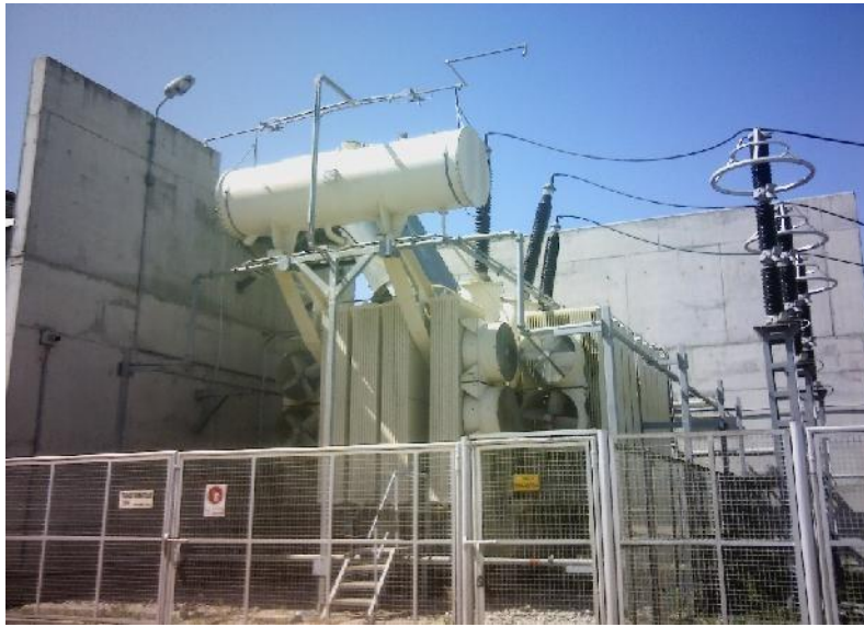
Figure IV.15 transformateur principal du groupe N°4.
