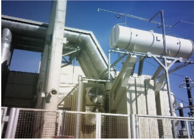
Figure IV.10 les gaines coaxiales MT du groupe N°3.
