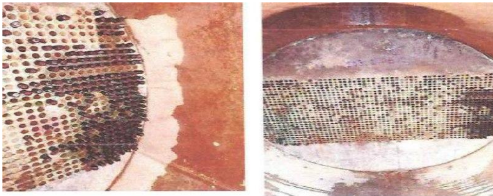
Figure II. 22 : Plaque tubulaire de l'échangeur existant
