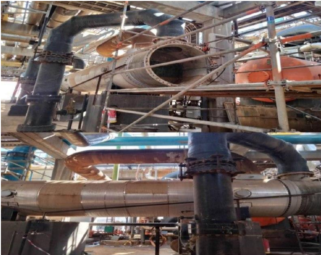
Figure II. 20 : Échangeur de chaleur (eau de mer / MCR)
