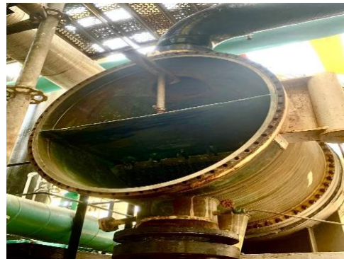
Figure II. 24 : Boîte de distribution
