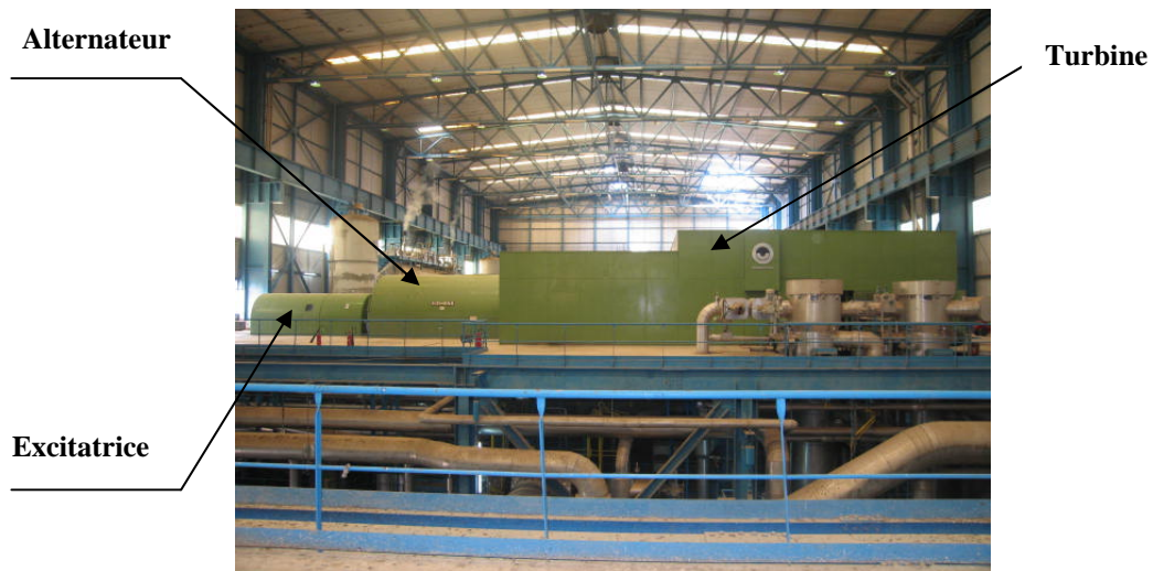
Figure 3.1 : Photo réelle de la turbine étudiée accouplée avec l'alternateur et l'excitatrice
