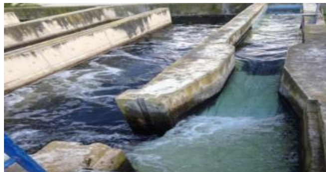
Figure 3.10 : Bassin de chloration.
