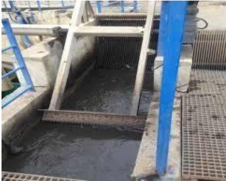
Figure3.5: Le dégrilleur automatique.
