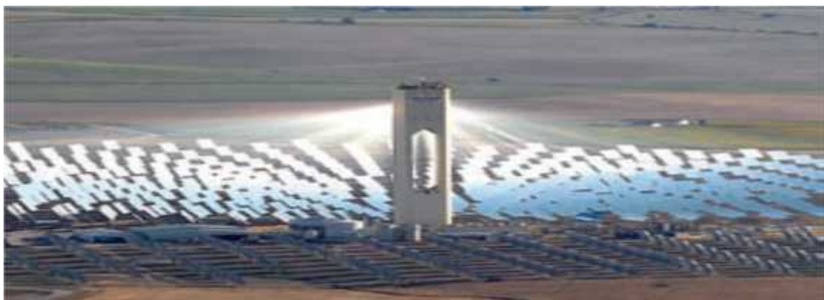
Figure I.3.7 : Centrales Solaires à Tour
