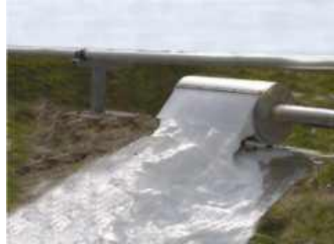
Fig.X.14 : Photo réelle de déversoir à mousse
