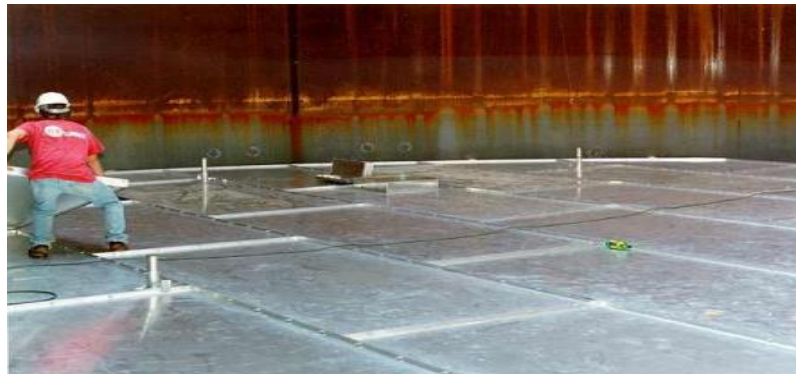
Fig.III.6: Vue du fond du réservoir
