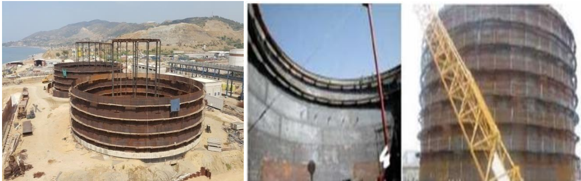
Fig III.3: Vue générale de la robe d'un réservoir
