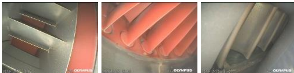
Figure II-13: Inspection interne des aubes de turbine à gaz Taurus 60 via une caméra de
