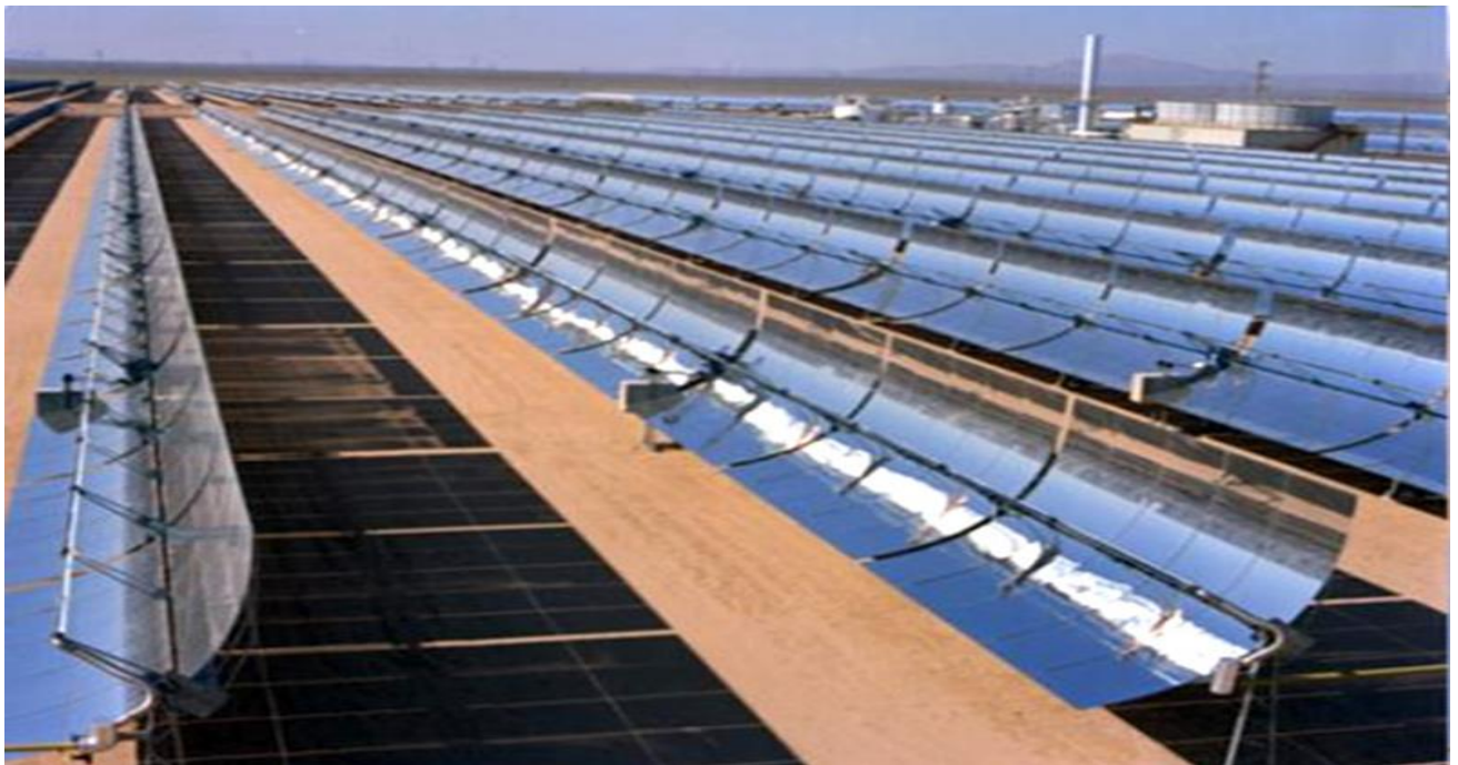
Figure 1-2 une centrale thermodynamique
