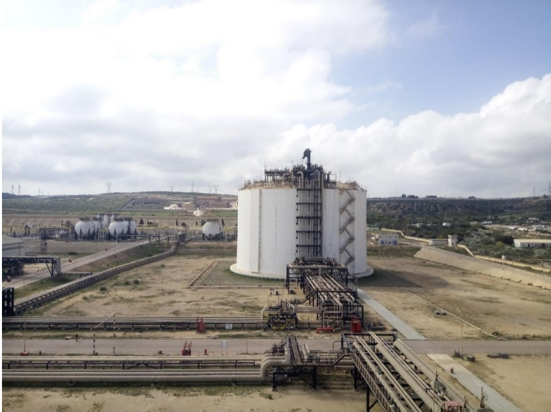
Figure III. 1: Vue générale de bac de stockage de propane T0001
