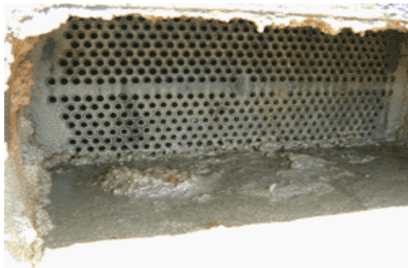
Figure III.6 : Dépôt de slime bactérien, hydrocarbures et oxydes métalliques dans un échangeur de chaleur eau hydrocarbures (Raffinerie de pétrole).
