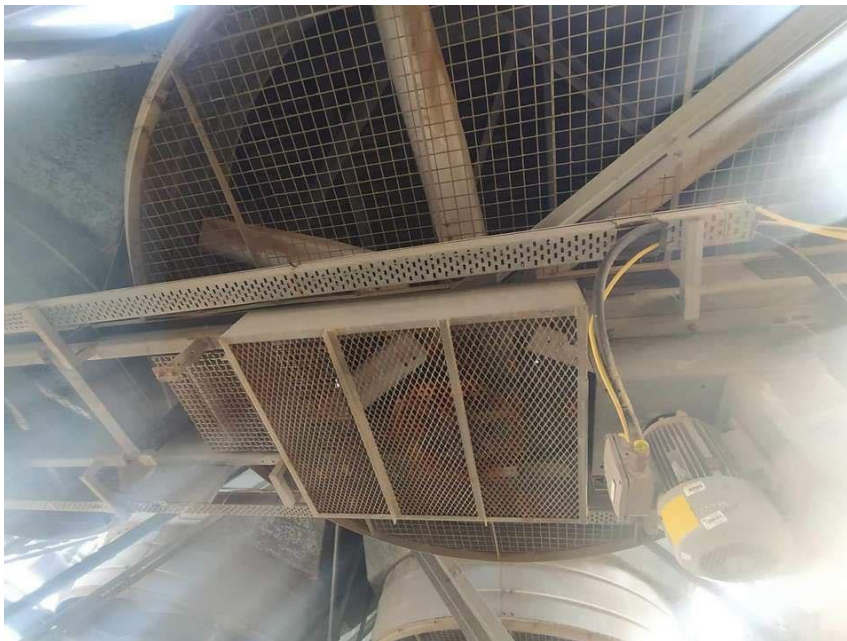
Figure 1.6: vue de dessous du aéroréfrigérant
