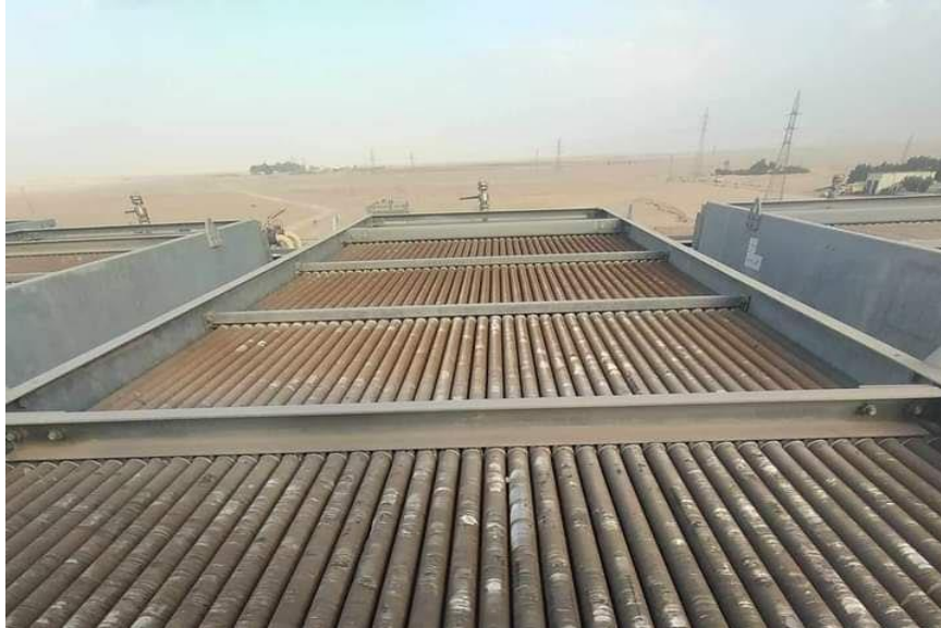
Figure 1.5: vue de dessus du aéroréfrigérant
