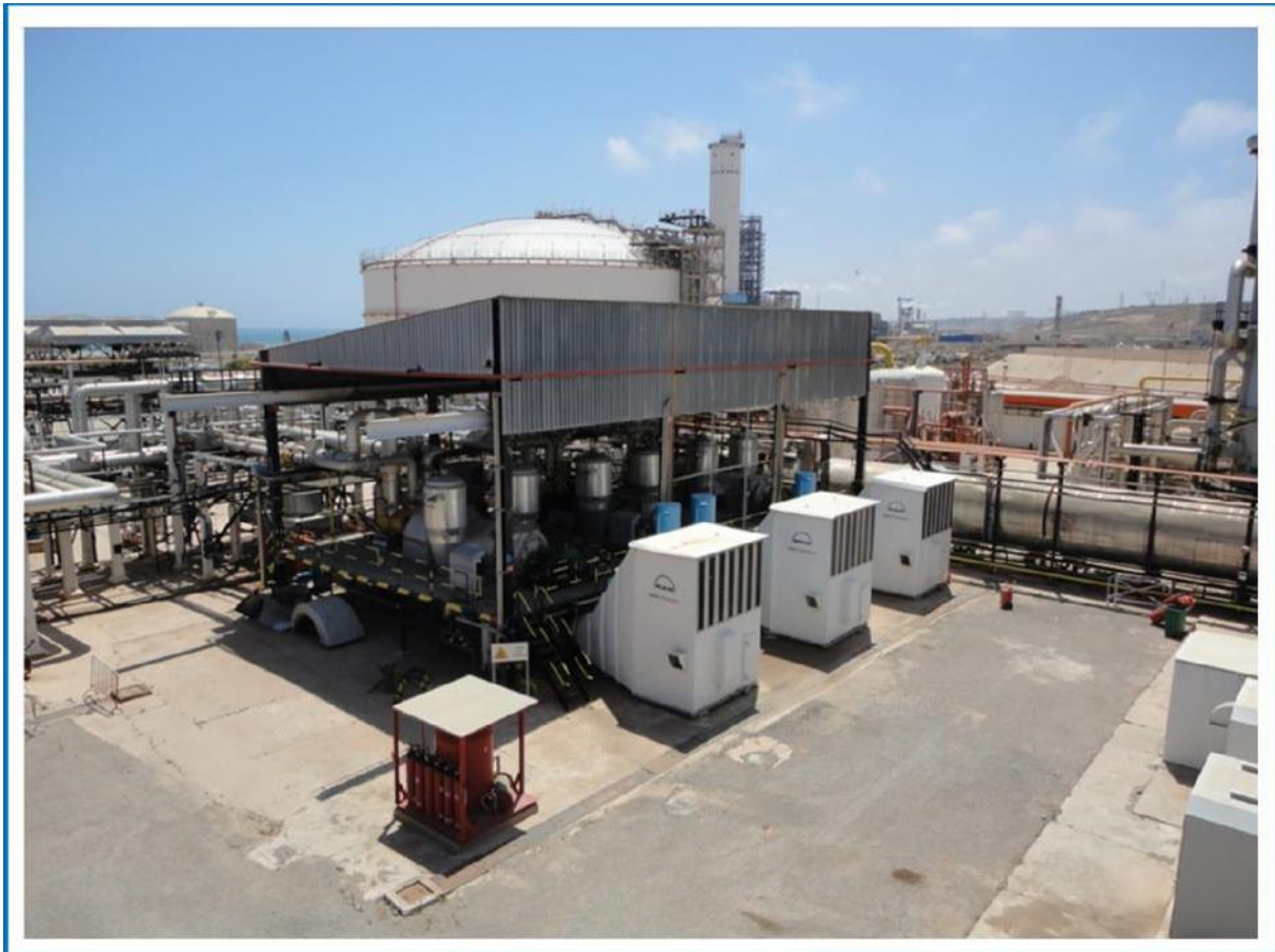
Figure N° 2.1 – Turbocompresseurs TCA, TCB et TCC du complexe GP2/Z
