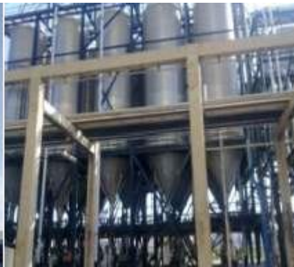
Figure 23: Silos de stockage des granulés
