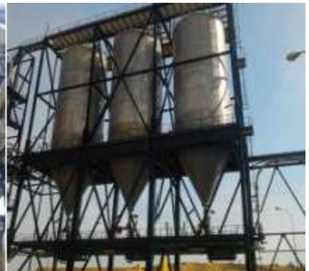
Figure 24 : Silos de stockage de la poudre en vrac
